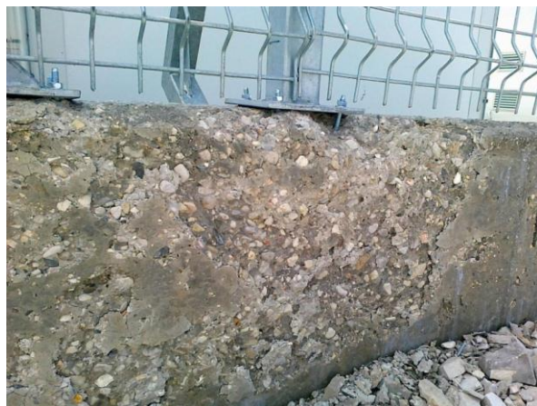
Foto 14: Demtimi i betonit për shkak të heqjes së parakohshme të armaturës
