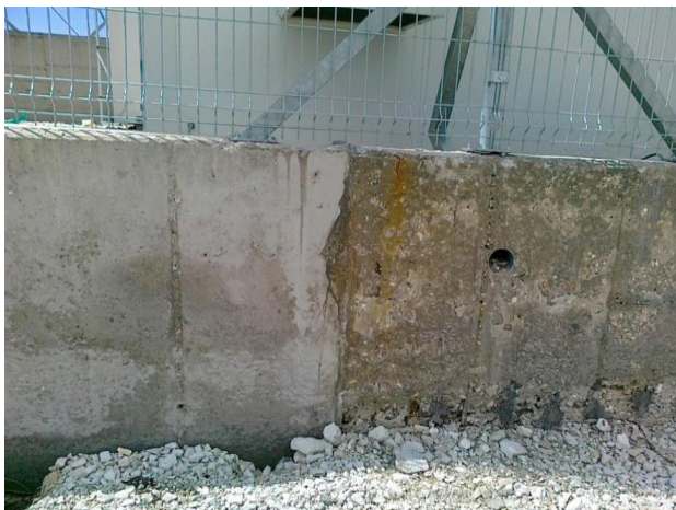
Foto 13: Demtimi i betonit për shkak të heqjes së parakohshme të armaturës
