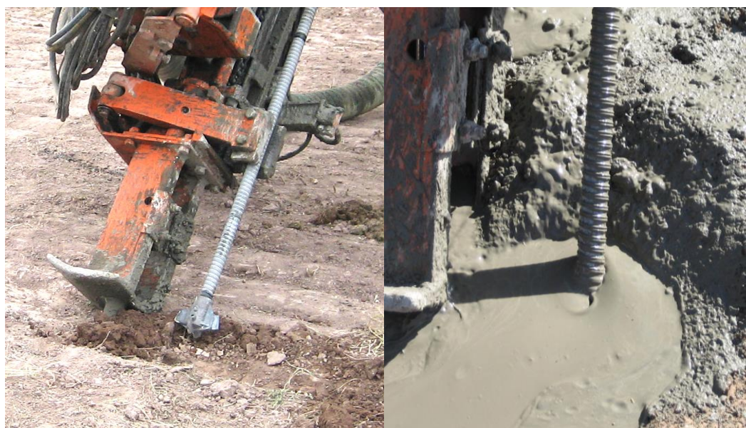
Figura N° 11 a: Perforación con inyección de lechada de cemento para un anclaje con barras ISCHEBECK
